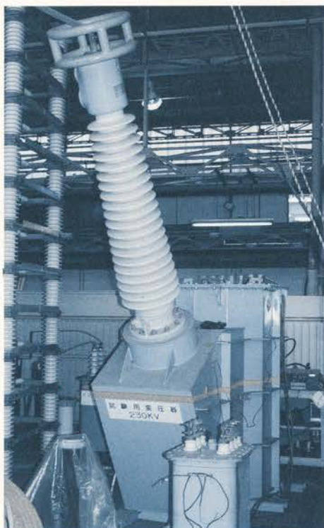
試験用変圧器 (Testing Transformer) 100kVA 230kV
