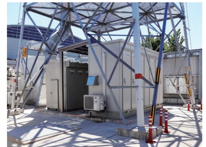
鉄塔敷地内に収まった変電所
