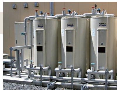
業務用並列給湯システム
