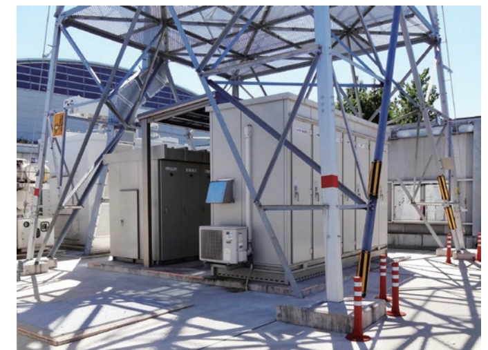
鉄塔敷地内に収まった変電所
