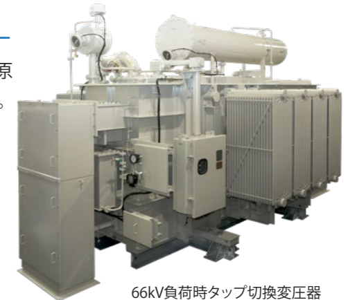
66kV負荷時タップ切替変圧器
