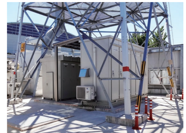
鉄塔敷地内に収まった変電所
