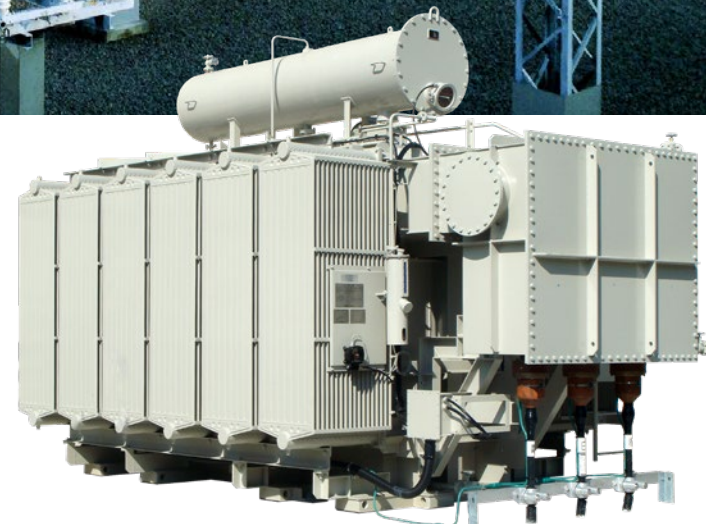
66kV 油中終端接続式変圧器
